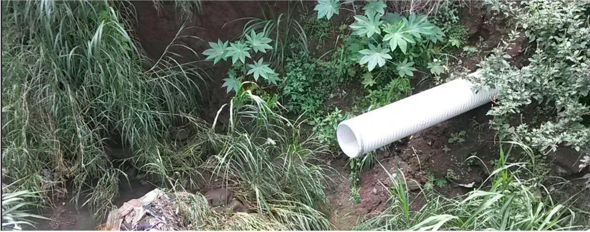
Figura 10. Desfogues y conexiones ilegales en los ríos de la microcuenca
