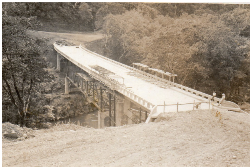
Figura 12. Puente actual, en la etapa final de su construcción. Fuente: Archivo Municipalidad de Turrialba
